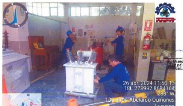
PRUEBAS DEL TRANSFORMADOR DE SECO DE 250 KVA
